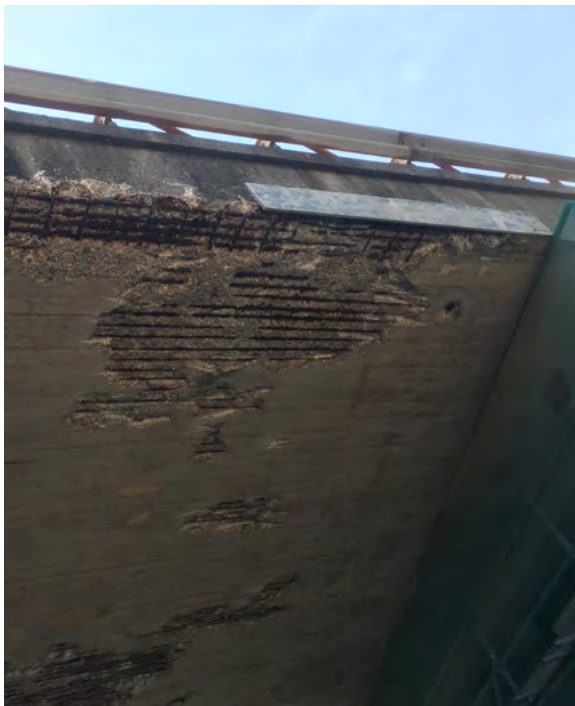
Ouderdom en slijtage in het spoorwegviaduct Sassenheim (A44).
